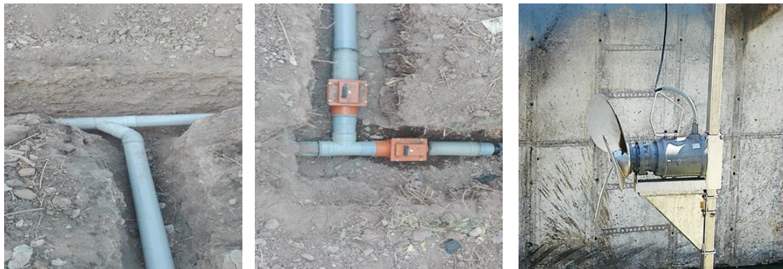
شکل ۲ - از راست: پروانه هوادهی، شیر کنترل ۲ طرفه، خط انتقال پساب به تصفیه خانه
