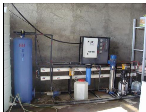
شکل ۳- سیستم نمک‌زدایی از آب نصب شده در گلخانه (به روش اسمز معکوس)
